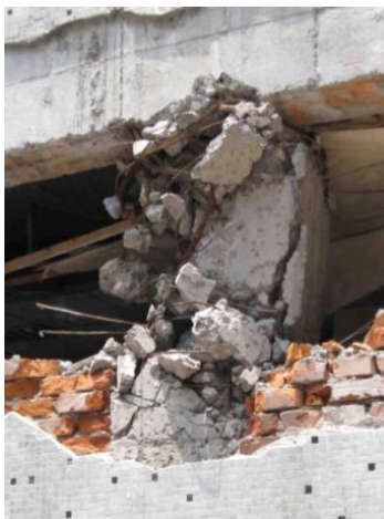
ภาพที่ 2 เสาคอนกรีตเสริมเหล็กที่ไม่ได้มาตรฐานในประเทศจีน [3]
